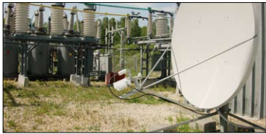
Спутники свяжут подстанции
